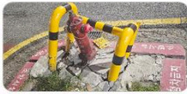
소화 시설 파손
