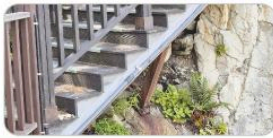
행사장 시설 파손
